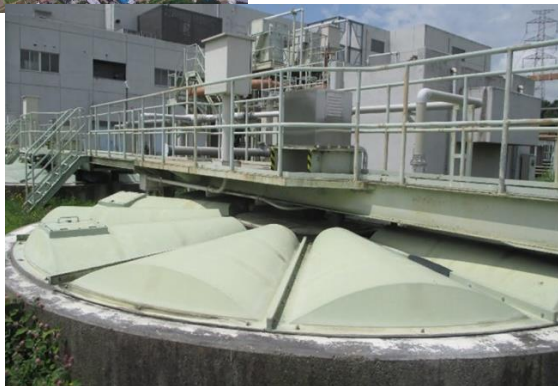
重力濃縮設備改築 下水汚泥を濃縮する設備の改築更新 [築33年経過（標準耐用年数15年）]
