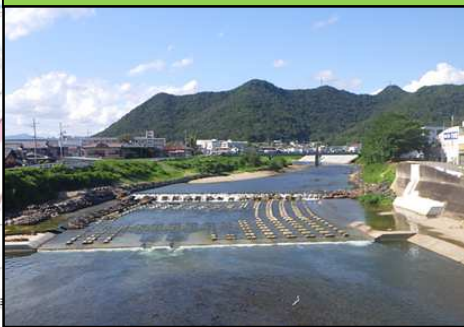
(西) 杉原川 沖田井堰上流の河床掘削、 護岸整備 (西脇市西脇～郷瀬町地内)
