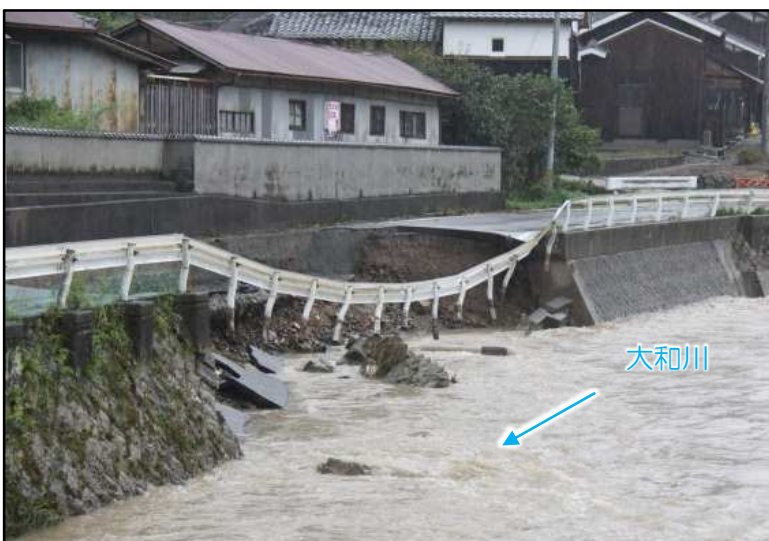
(一) 大和川 河川兼用護岸道路崩壊 (多可郡多可町八千代区大和)
