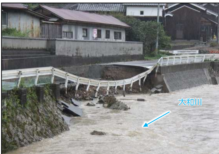
(一) 大和川 河川兼用護岸道路崩壊 (多可郡多可町八千代区大和)
