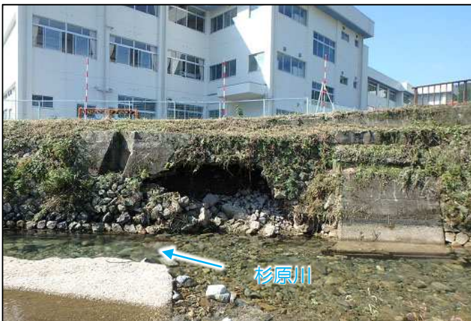
(一) 杉原川 増水による法面崩壊 (多可郡多可町加美区熊野部)
