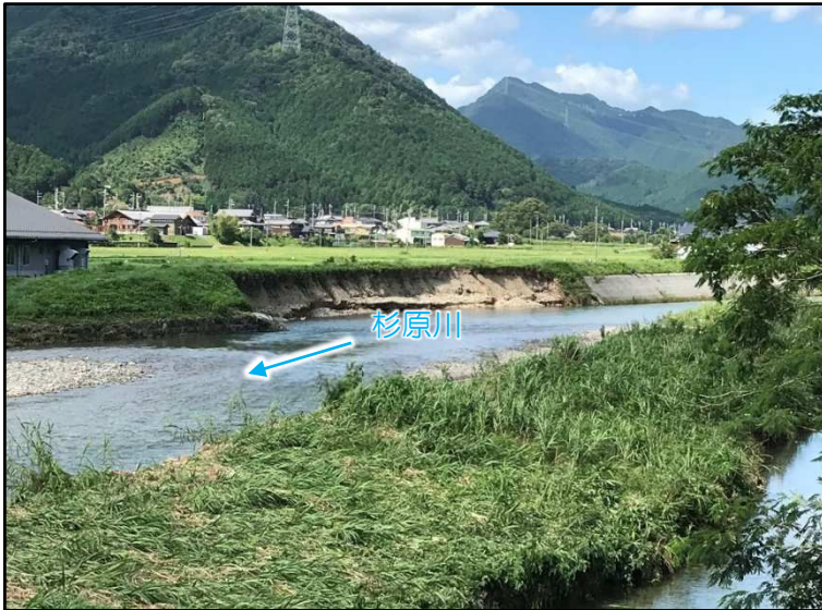
(一) 杉原川 増水による堤防崩壊 (多可郡多可町加美区豊部)
