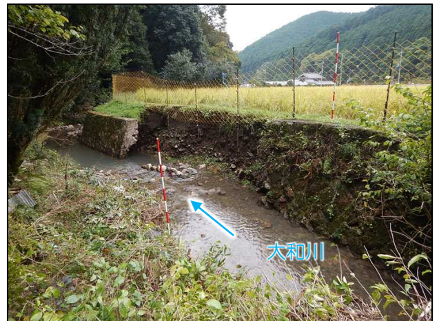
(一) 大和川 増水による護岸崩壊 (多可郡多可町八千代区上三原)
