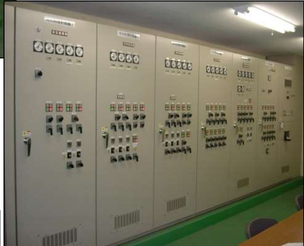
汚水処理制御盤
