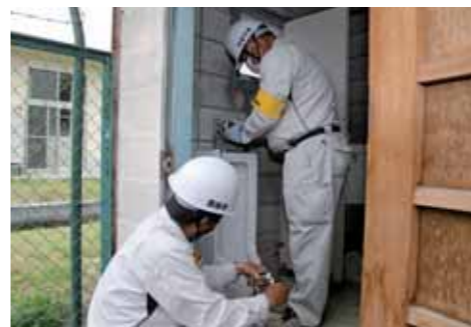
不良箇所を確認し、設備の部品を交換する西脇市上下水道協同組合の皆さん
