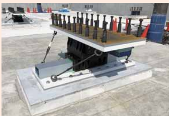
▲免震装置（新庁舎建設地／4月10日）
