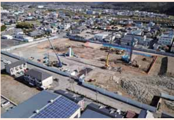
▲基礎工事に向けて土地を掘削（新庁舎・市民交流施設建設地／11月15日）
