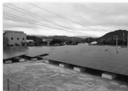
北播磨清掃事務組合最終処分場跡地に整備した西脇市太陽光発電所
