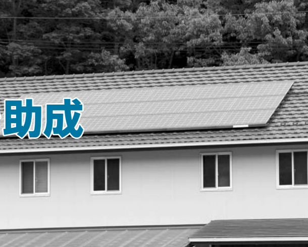
▲屋根に設置された太陽光パネル
