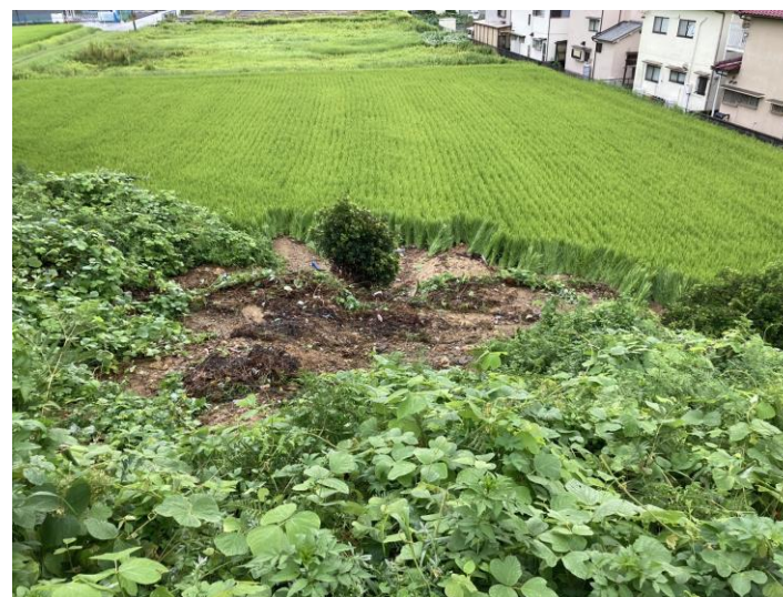
野村町 法面崩壊
