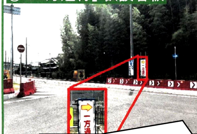
①「一方通行」仮設看板
