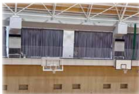
体育館の空調設備の整備
