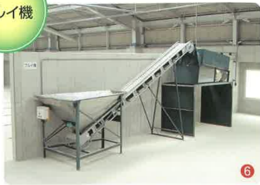
混合槽 混合機
